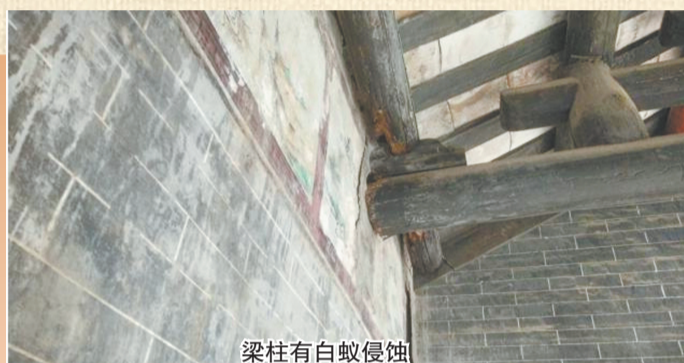
梁柱有白蚁侵蚀
